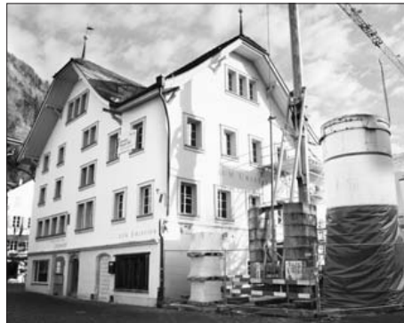
Der Umbau und die Sanierung des «Lehnhof» in Altdorf laufen derzeit auf Hochtouren. FOTO: MARTINA REGLI
